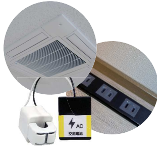
キャンパス内の各棟、各教室等の電力使用量を監視
